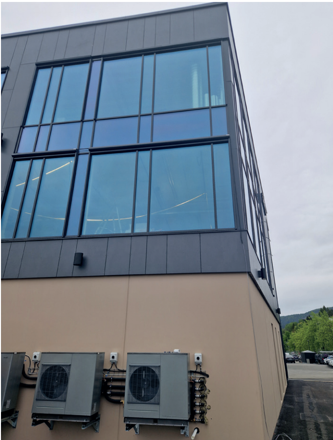
Varmepumper på østsiden av bygget.
